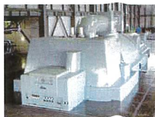
タービン・発電機
