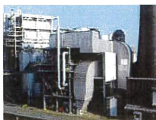
排煙脱硫設備
